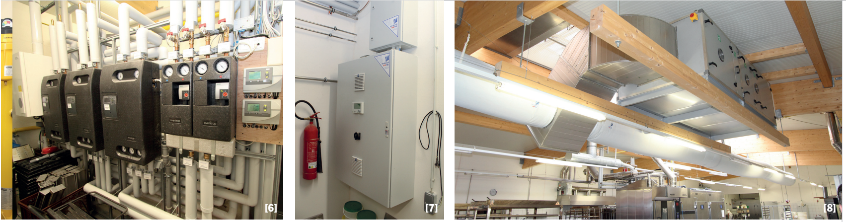
[6] Im Technikraum befindet sich direkt neben den Pufferspeichern die Wärmeverteilung für die verschiedenen Heizkreise, zu denen die Frischwassermodule für das Warmwasser in der Produktion, für die sanitären Anlagen und das Heißwasser für die Spülmaschinen sowie die Regelsets der Fußbodenheizung für die Büros und Sozialräume gehören. [7]+[8] Im gleichen Raum ist auch die Computersteuerung für die vollautomatische, kombinierte Heizungs-, Be- und Entlüftungsanlage untergebracht. Diese sorgt unter Berücksichtigung der Außentemperatur und der vorhandenen Luftfeuchtigkeit für ein konstantes, optimales Backstubenklima.
